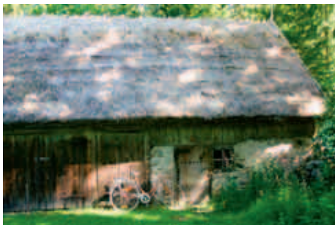
Det södra takfallet med första tecknet på slitet tak där täckespröten börjar krypa fram.
