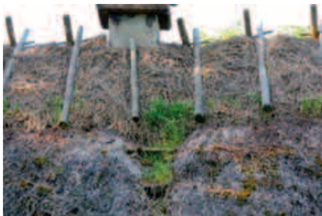
Takfallet mot norr med en skada under skorstenen.
