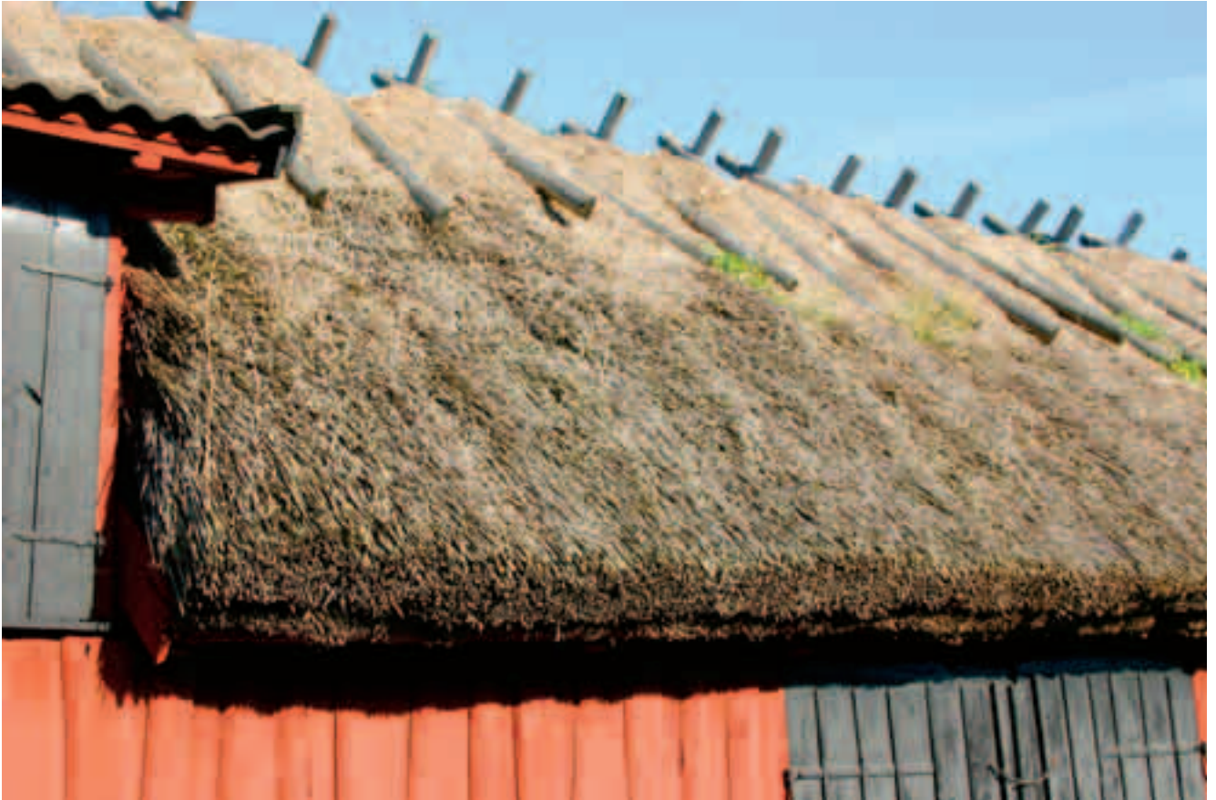
Det östra takfallet över logporten där regnet åstadkommit "rännor" i takmaterialet.
