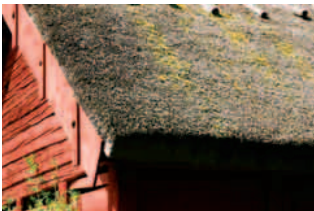
Öfsen på det östra takfallet och en början till mosspåväxt på takytan beroende på en nära växande lönn.
