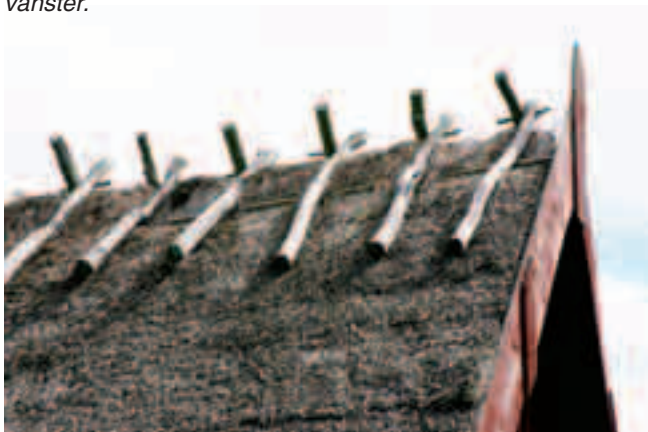
Mörning saknas och de underliggande täckespröten har blottats.
