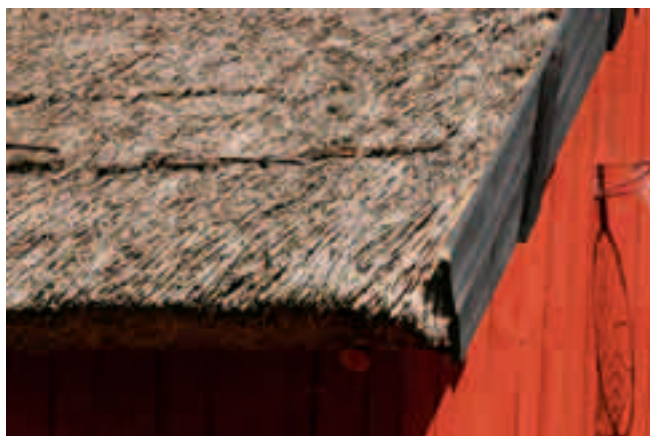
Öfsen på västra takfallet där täckespröten blottats.
