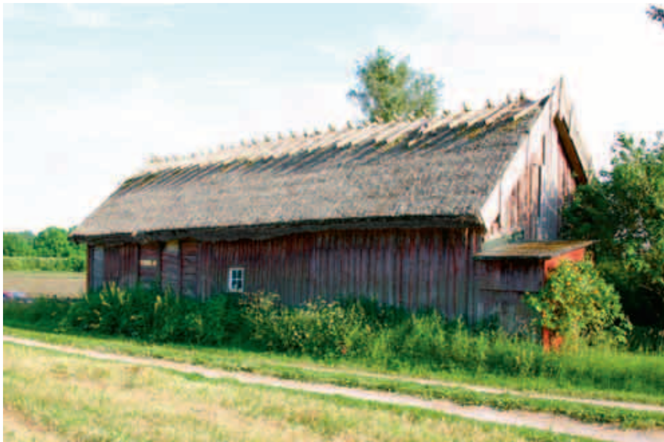
Ladugårdens norrfasad. Pallträns ändrar har lyft från takytan eftersom mörningen blåst av.
