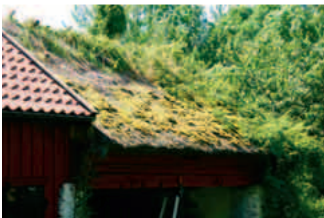
Det norra takfallet med påväxt av mossa m.m.
