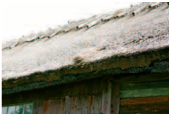
Det västra takfallet med skada över logen.
