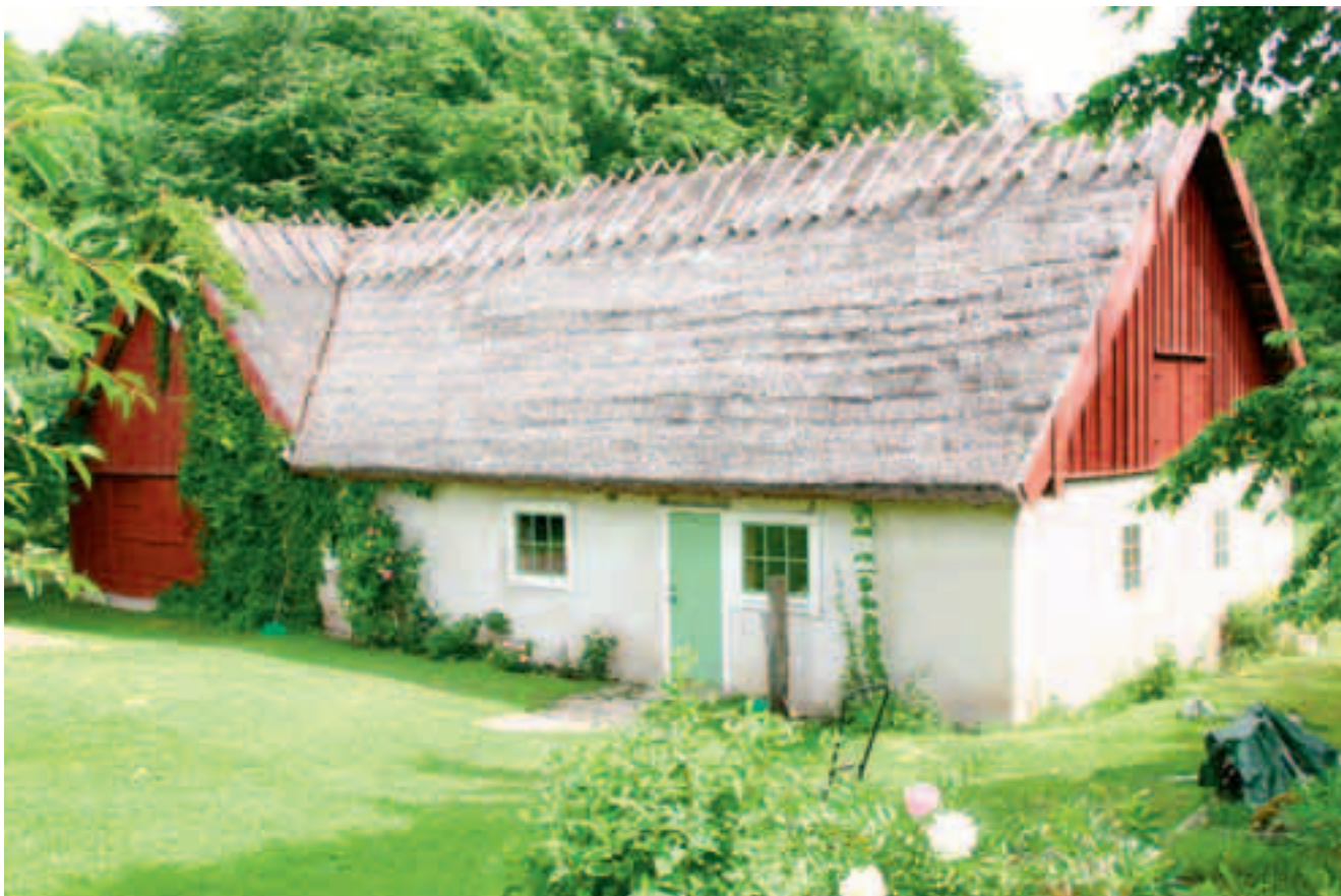
Fasad mot väster med gaveln efter den nedrasade delen till vänster.
