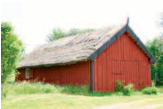
Ladugårdens norra takfall är kraftigt nedslitet.
