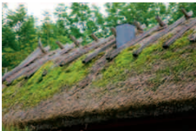
Det norra takfallet med mosspåväxt och håll vid ventilationstrumma.
