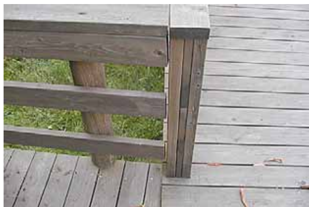
Ramper separeras från plattformen med en springa så att inte stegvibrationer fortplantas. Här behöver dock springan sågas upp efter sättningar.
