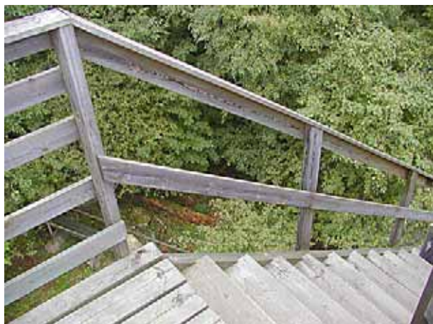
Den här branta trappan utgör en stor risk vid ett eventuellt fall. Att den dessutom är på hög höjd och har ett glest räcke förvärrar risken ytterligare.
