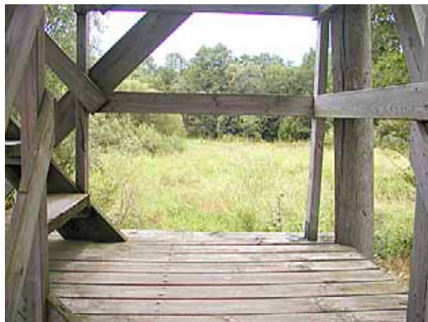
En stor öppning där såväl barn som vuxna skulle kunna ramla ut vid ett eventuellt fall.
