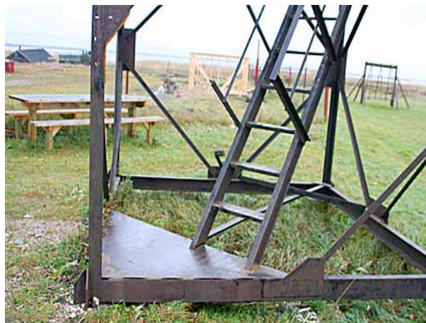
Höga branta trappor med ett smala steg och stor steghöjd med halkigt stål innebär en stor risk för fallolyckor.
