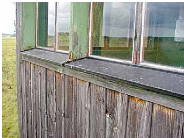
Målning med tät färg har orsakat rötskador. Obehandlade ytor är oskadda trots sina 50 år.
