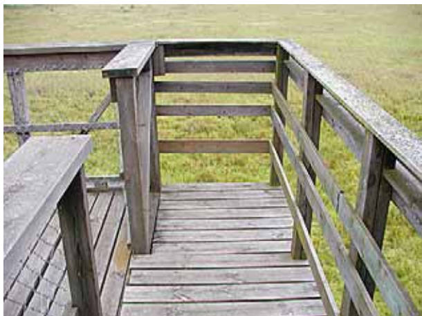
Horisontella brädor lockar till farlig klättring, dessutom stora öppningar där barn skulle kunna krypa igenom.
