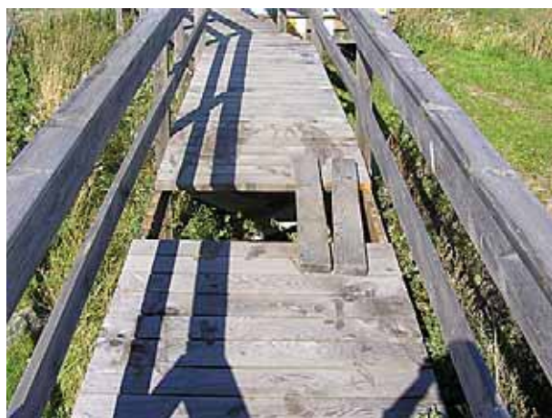
Väl utformad ramp, som utsatts för skadegörelse. Snabb insats krävs för att den ska fungera för en rullstolsburen.
