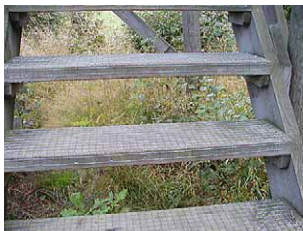
Här har ett nät lagts i den branta trappan för att ge ett bättre fotfäste vid blöt väderlek.
