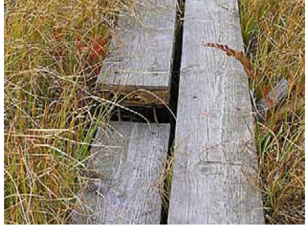
Spång över en blöt myr. Här har stommen brustit och plankerna ser dåliga ut. Dags för ombyggnad.
