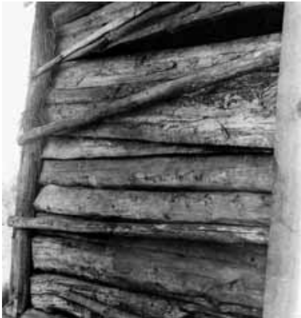
Detalj av förfallen lada i skiftesverk, Rise-Justins, Tveten i Frändefors. Hörnstolparna är intappade i syllen. Klent rundvirke eller halvkluvor är infällda i skåror i stolparna. Notera också resterna av halmklädsel fäst med slanor uppe till vänster. (GvSINM 1950)
