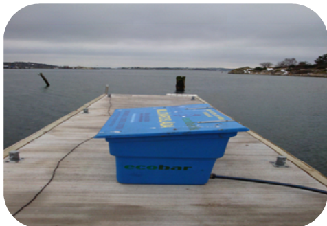
Sugtömningsstationen, Grebbestad. Stationen är kopplad till uppsamlingstanken till höger
