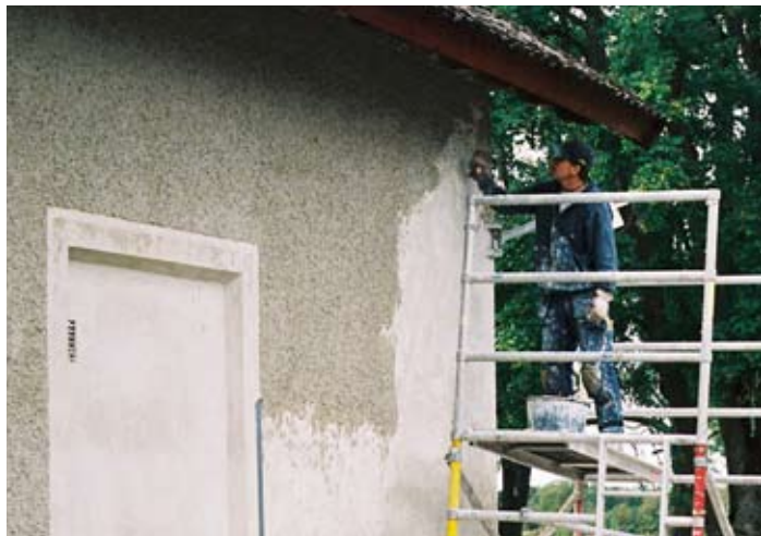
Från vänster: Skadorna på ladugården • Stallet under arbete.
