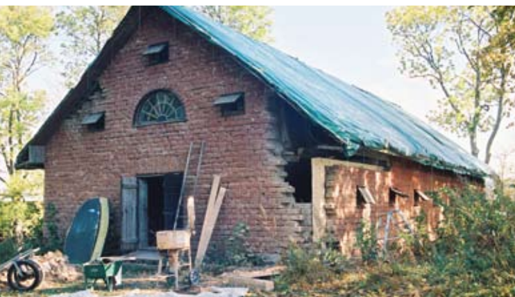
Från ovan: Lerstensmurning • Lerstensmagasinet hade stora skador.
