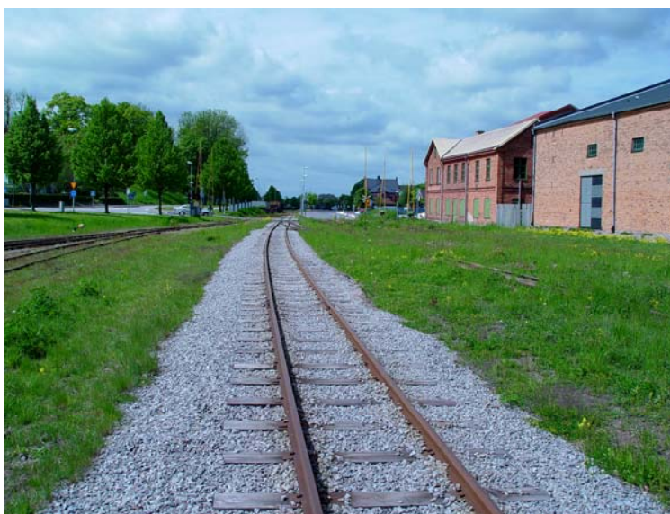
Fig. 20. "Museijärnvägen" vid Scara gamla järnvägsstation. Floristiskt och faunistiskt värdefull miljö som hör intimt ihop med järnvägens hela historia i Skara har skadats svårt genom utläggning av nyproducerad, främmande stenkross. Projektets fokus har ej legat på autenticitet. 24/5.
