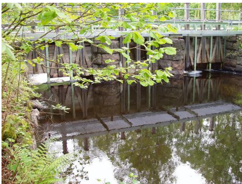
Foto 17. Vandringshinder i Hyltenäsån, Tolken regleringsdamm uppströms.
