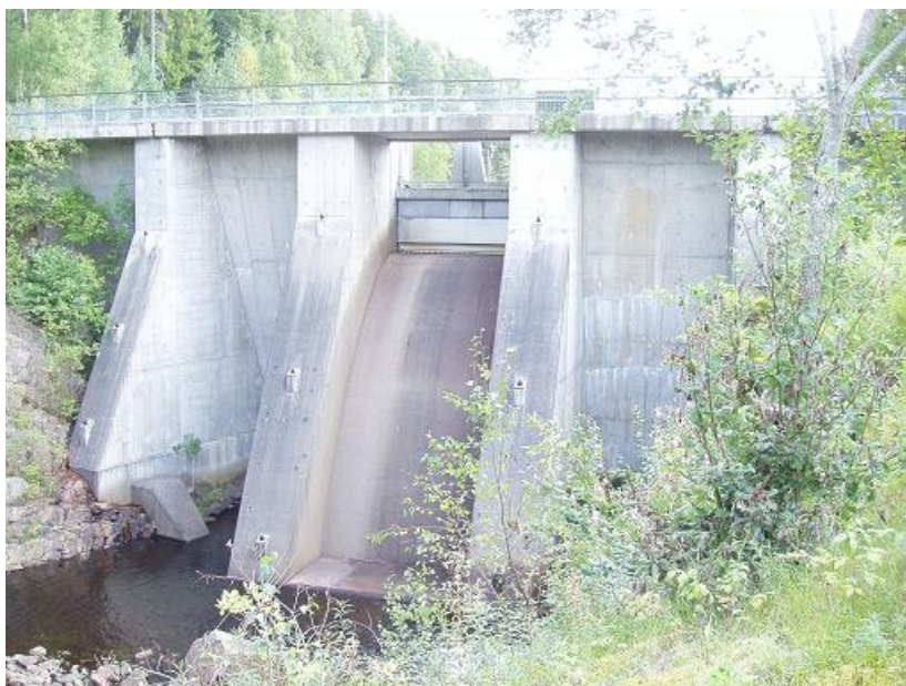
Foto 28. Vandringshinder 3. Strömmens kraftverk, Torestorpsån.
