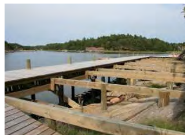
Ett av de äldre magasinerna har rasat samman, men grunden är lagd för en ny byggnad.
