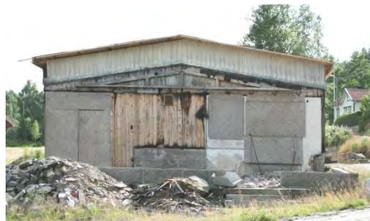
2010 har främre delen av byggnaden rivits efter ett rivningsföreläggande. Resterna ligger kvar på marken.
