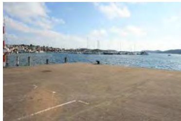
Den Stora kajen är öde och i dåligt skick. Den ligger relativt oskyddad i den norra delen av hamnen.
