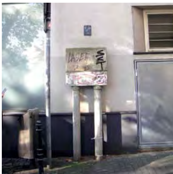
Figur 43. Översvämningssanpassat elskåp – Köln, Tyskland.
