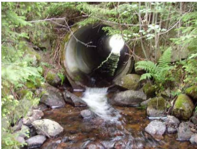
Dåligt placerad vägtrumma i Torpbäcken. Foto: Länsstyrelsen i Västra Götalands län.
