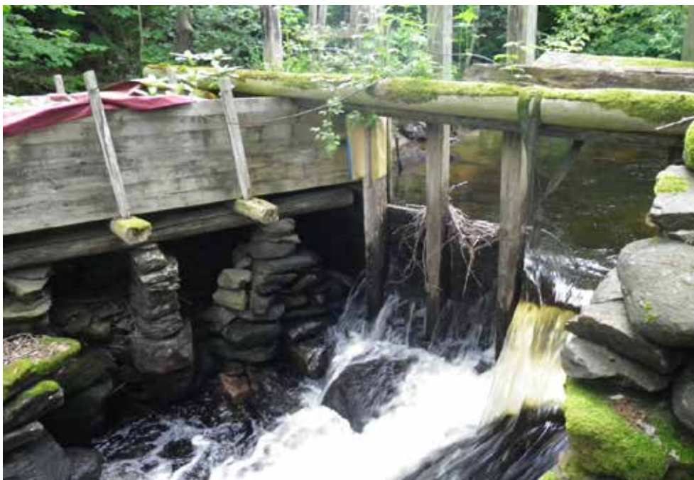
Figur 94. Hinder 3 i Fälån är ett definitivt hinder som utgörs av en damm.
