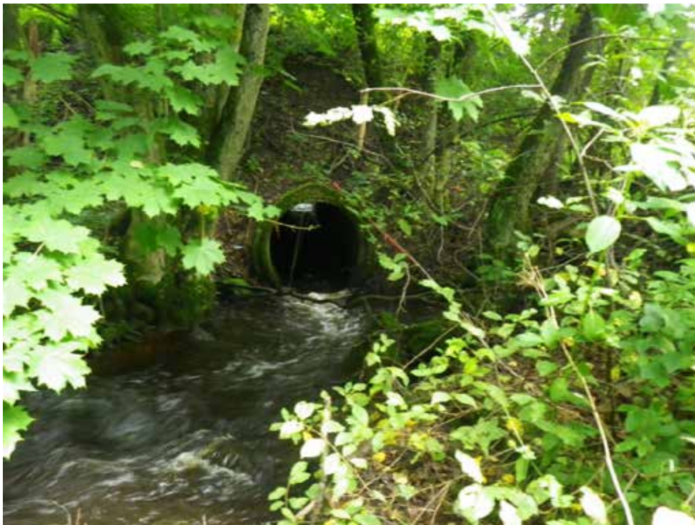
Figur 39. Vandringshinder 4 i Skrålabäcken. En vägtrumma där vattnet rinner igenom med ett snabbt laminärt flöde som är svårt för framförallt små fiskar att simma igenom.
