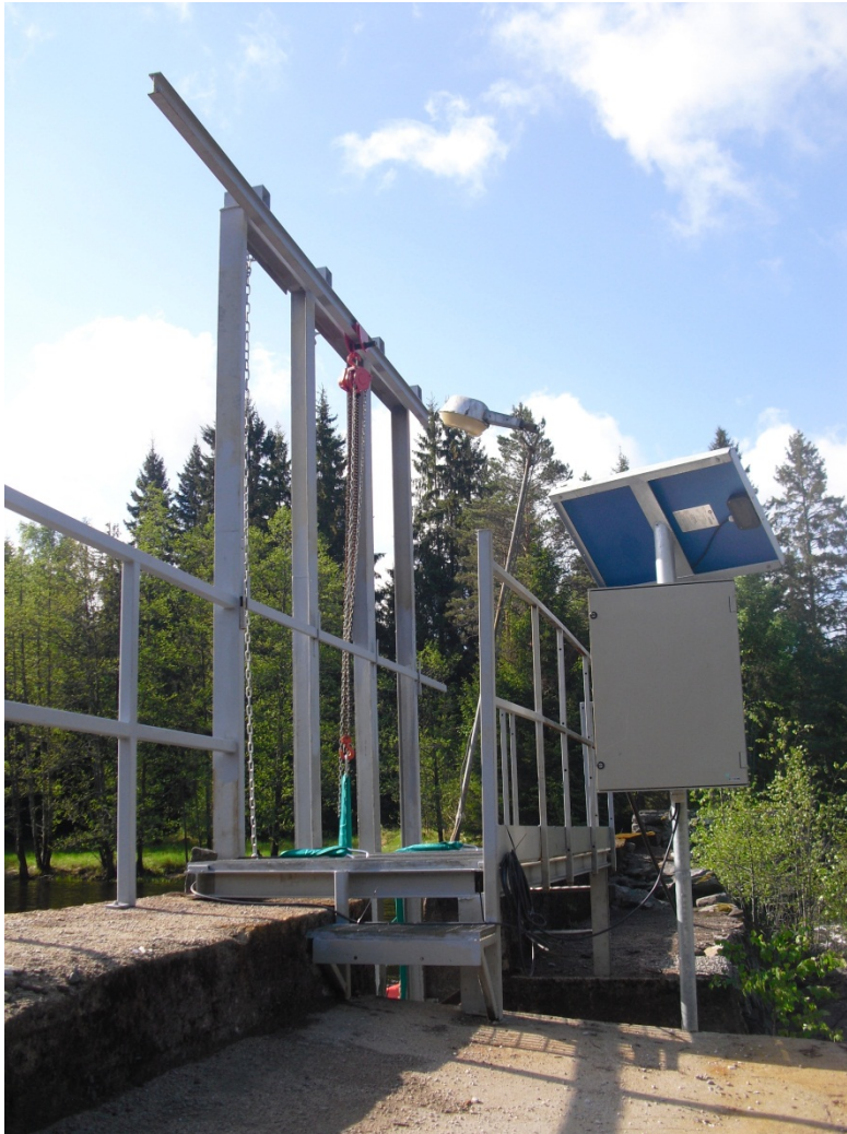
Bild. Utöver själva fiskräknaren som är nedsänkt i vattnet består anläggningen för fiskräkning av en service-/underhållsbrygga, lyftanordning, instrumentskåp för dator och modem m.m. samt solpanel för strömförsörjning. Foto: Daniel Johansson
