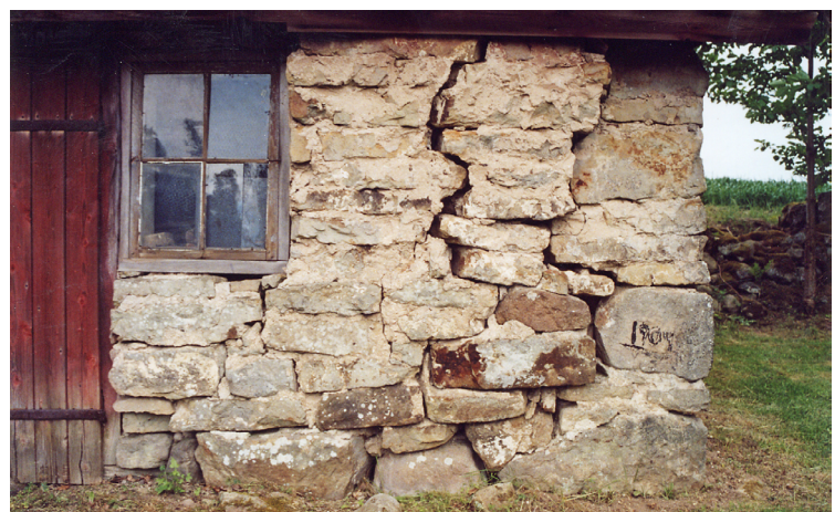
Ett hörn av murverket har börjat spricka sönder. Foto TCq, jun-06, 06/14:19.
