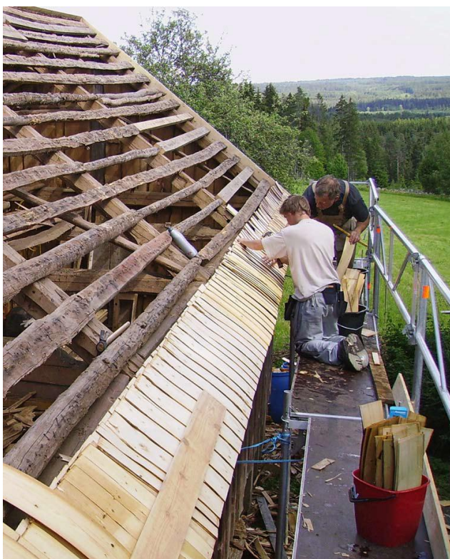
Omläggning av spåntak på ladugården vid torpet Korsberga i Ulricehamns kommun. Foto genom bidragstagaren.
