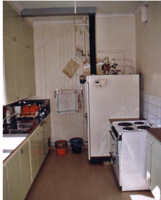
Kombinerat kök och pannrum
