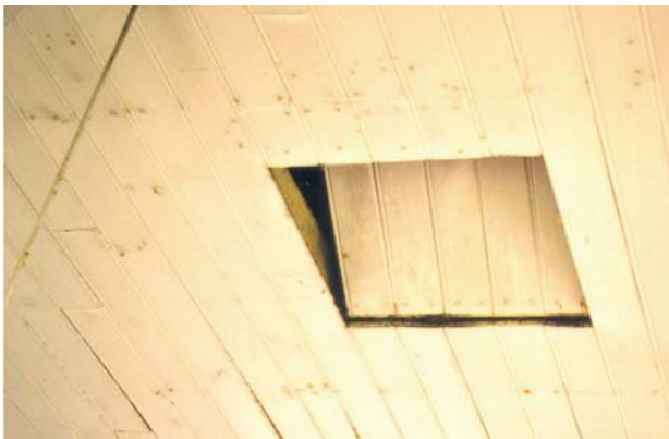
I taket finns en ventilationslucka , som regleras med repet till vänster i bilden
