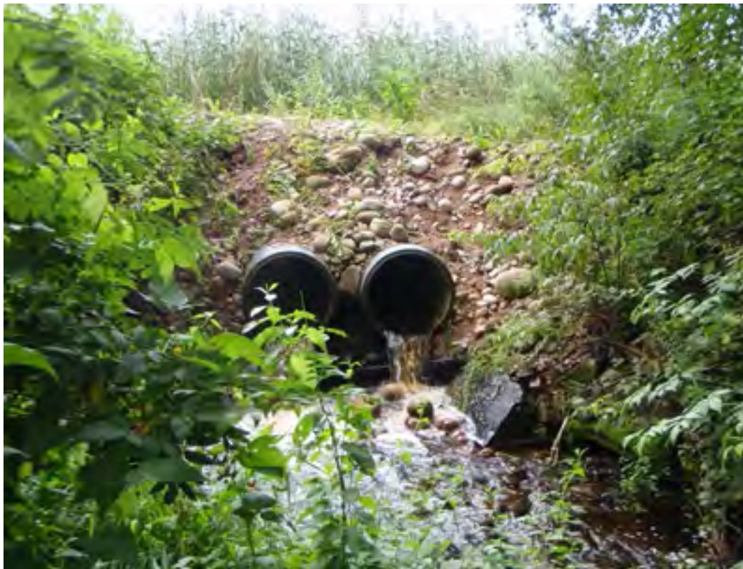
Bilden visar vägtrummor som är fellagda, vilket innebär att de är ett vandringshinder för vattenlevande djur. Foto: Hans Nilsson.
