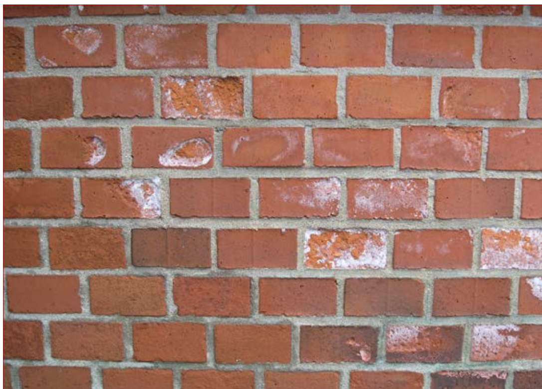
Figur 6.8. Problematiskt sekelskiftesmurverk, Fässbergs kyrka 2007. Saltsprängning på grund av att murverket inte kan hantera fukt. Foto: Tomas Brandt, Bohusläns museum.
