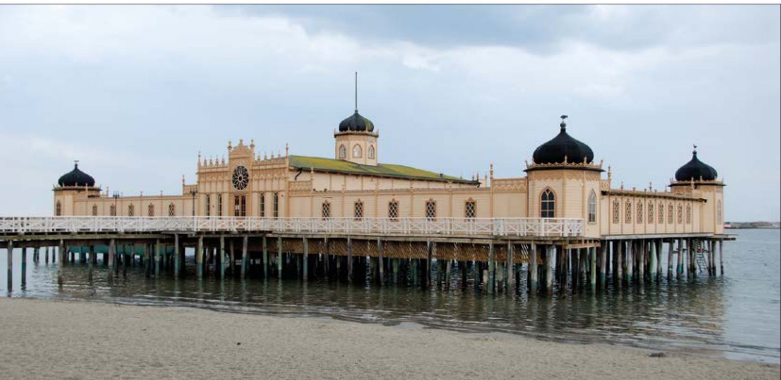
Figur 6.1. Varbergs kallbadhus. Vintern 2011 drabbades det av skador på framför allt pålarna, i en kombination av storm och ismassor. I en framtid, när havet står en meter högre, kan motsvarande skador bli betydligt allvarligare. Foto: Dennis Axelsson, Kulturmiljö Halland.
