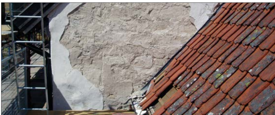
Figur 6.2 Bristande avvattning leder till fukt i intilliggande byggnadsdelar. Bokenäs kyrka 2008, nedfrusen puts på grund av otillräcklig avvattning. Foto: Foto: Tomas Brandt, Bohusläns museum.
