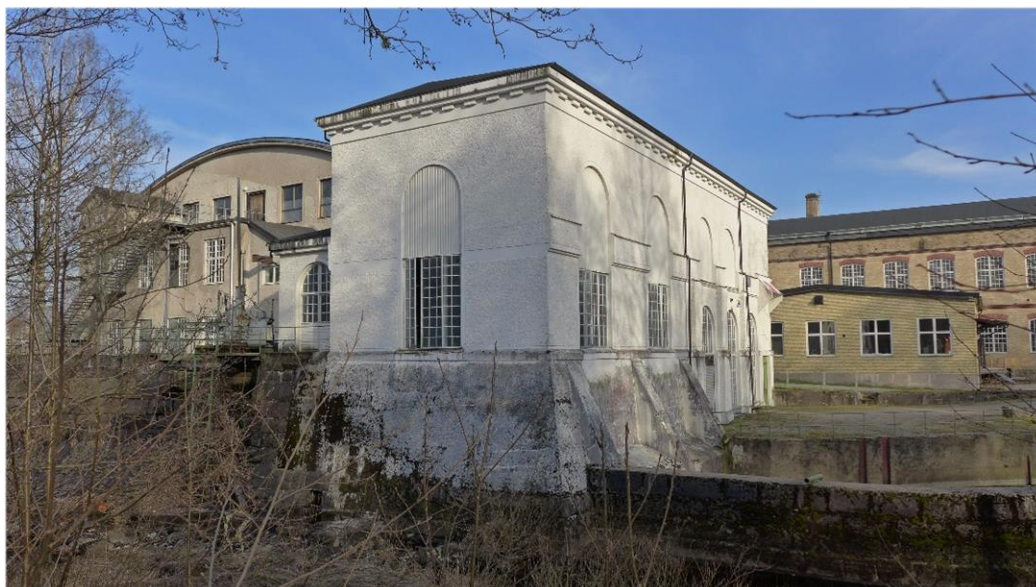
Rydals kraftverk är uppfört 1914–16 för den egna textiltillverkningen. Kraftverket ingår i byggnadsminnet Rydals fabriker och har i aktuell inventering värderats mycket högt.
