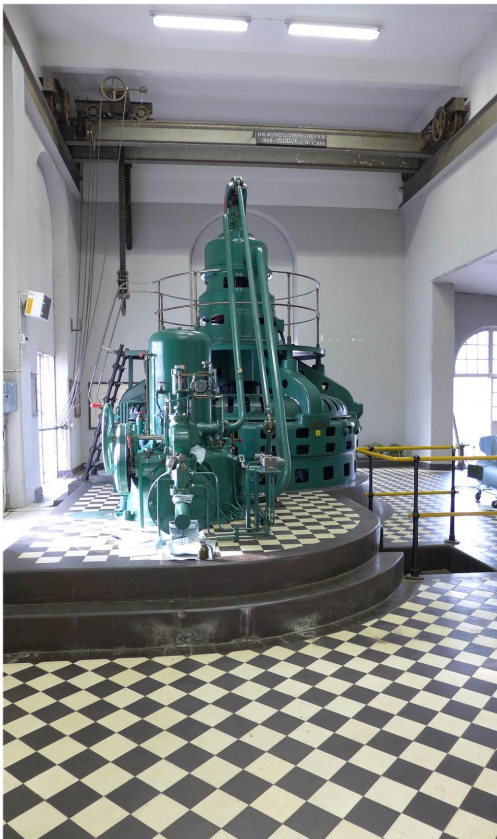
Interiörbild från Rydals kraftverk. Kaplanturbinen är installerad 1927 och är fortfarande i drift. Kraftverket ingår i byggnadsminnet Rydals fabriker.
