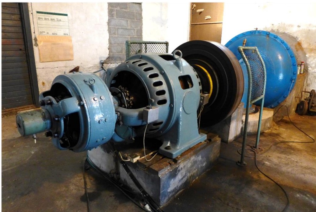
Den ursprungliga francisturbinen finns bevarad. Generatoren är bytt men ersatt med en likadan som tidigare.
