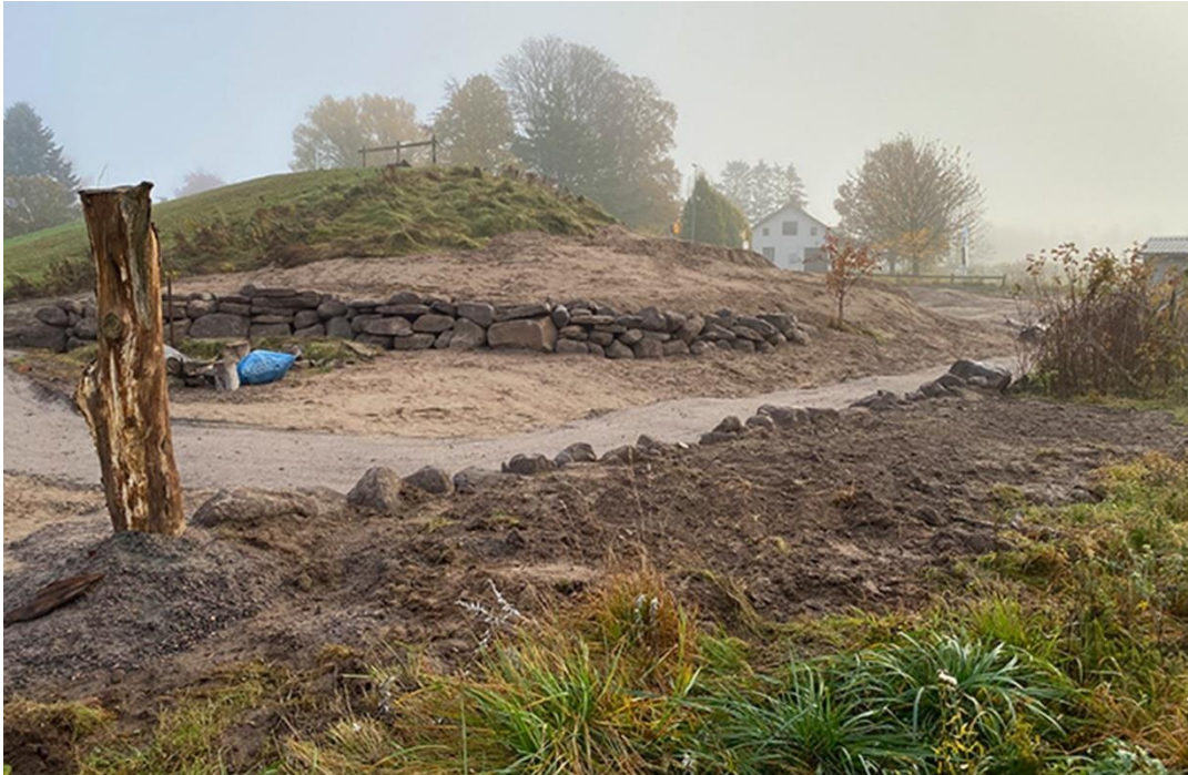
Figur 22. Biparadiset i Broddetorp under konstruktion. Här skapas rika miljöer med blottad sand i söderläge, död ved, samt träd, buskar och torrängsanläggningar för födoresurser under hela pollineringssäsongen. Foto: Petter Bobman
