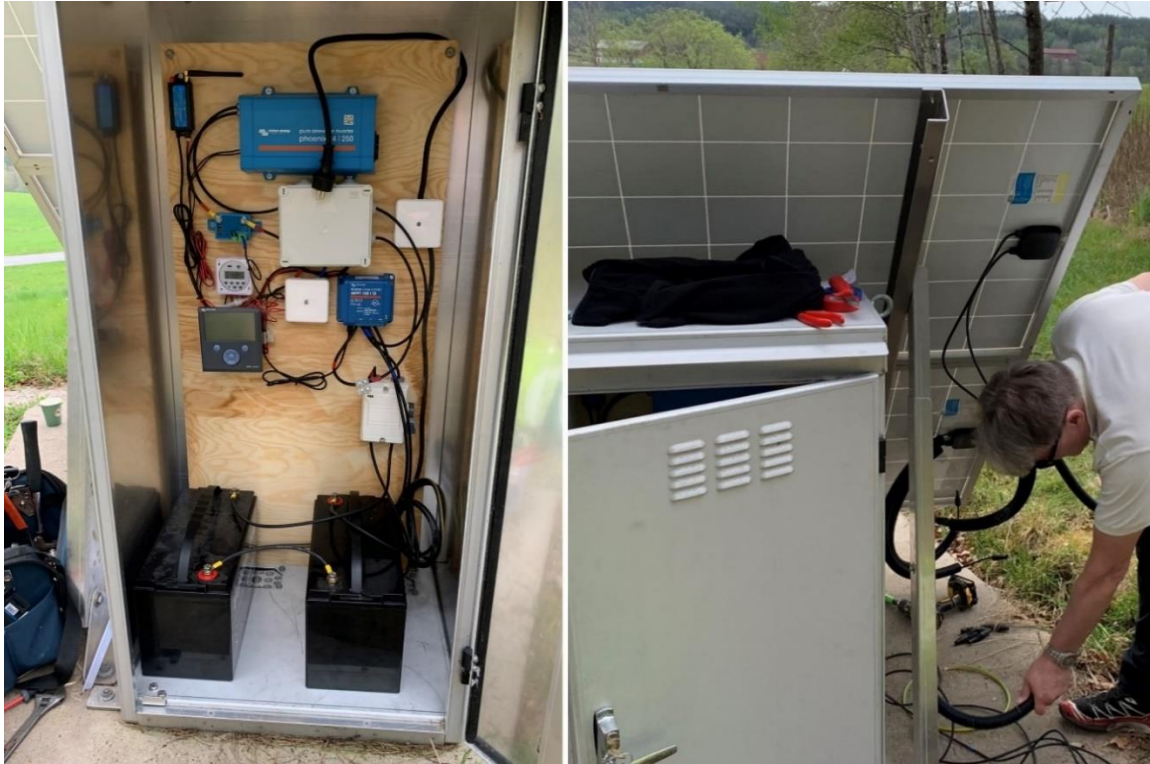
Figur 9. Solcellspanelen med tillhörande elskåp monterade på ett betongfundament i Fossum. Foto: Henrik Zedig, Länsstyrelsen Västra Götaland 2019.
