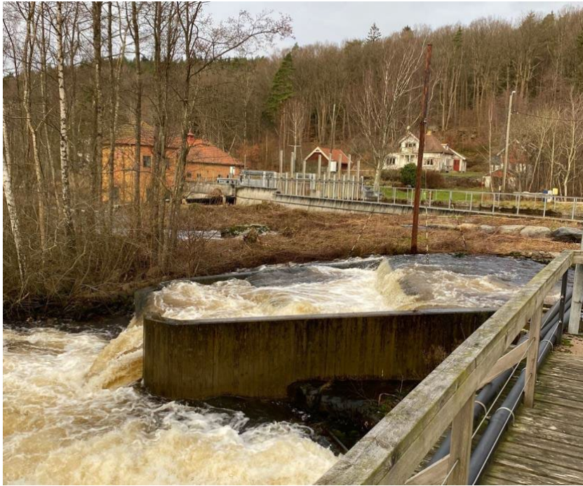
Bild 6. Den tekniska fiskvägen vid Ålgårda vid hög vattenföring. Omlöpet kan skönjas bortanför fiskvägen. Foto: Länsstyrelsen.
