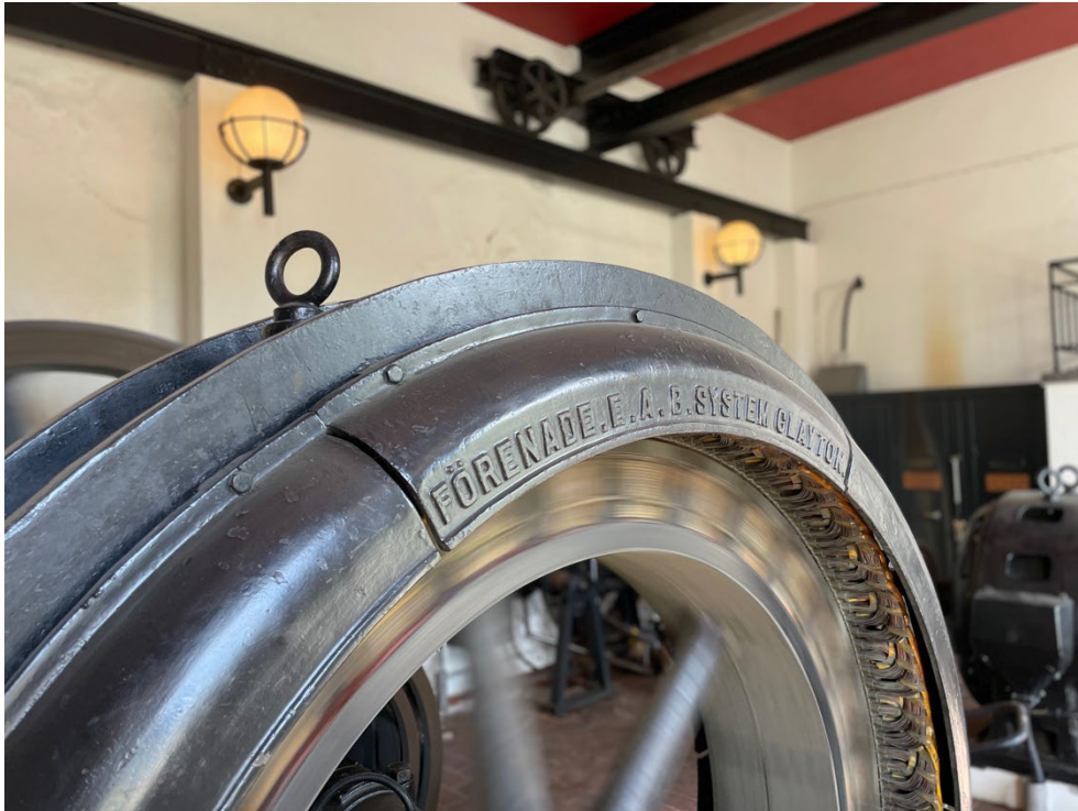
Närbild av den större av kraftverkets två generatorer.
