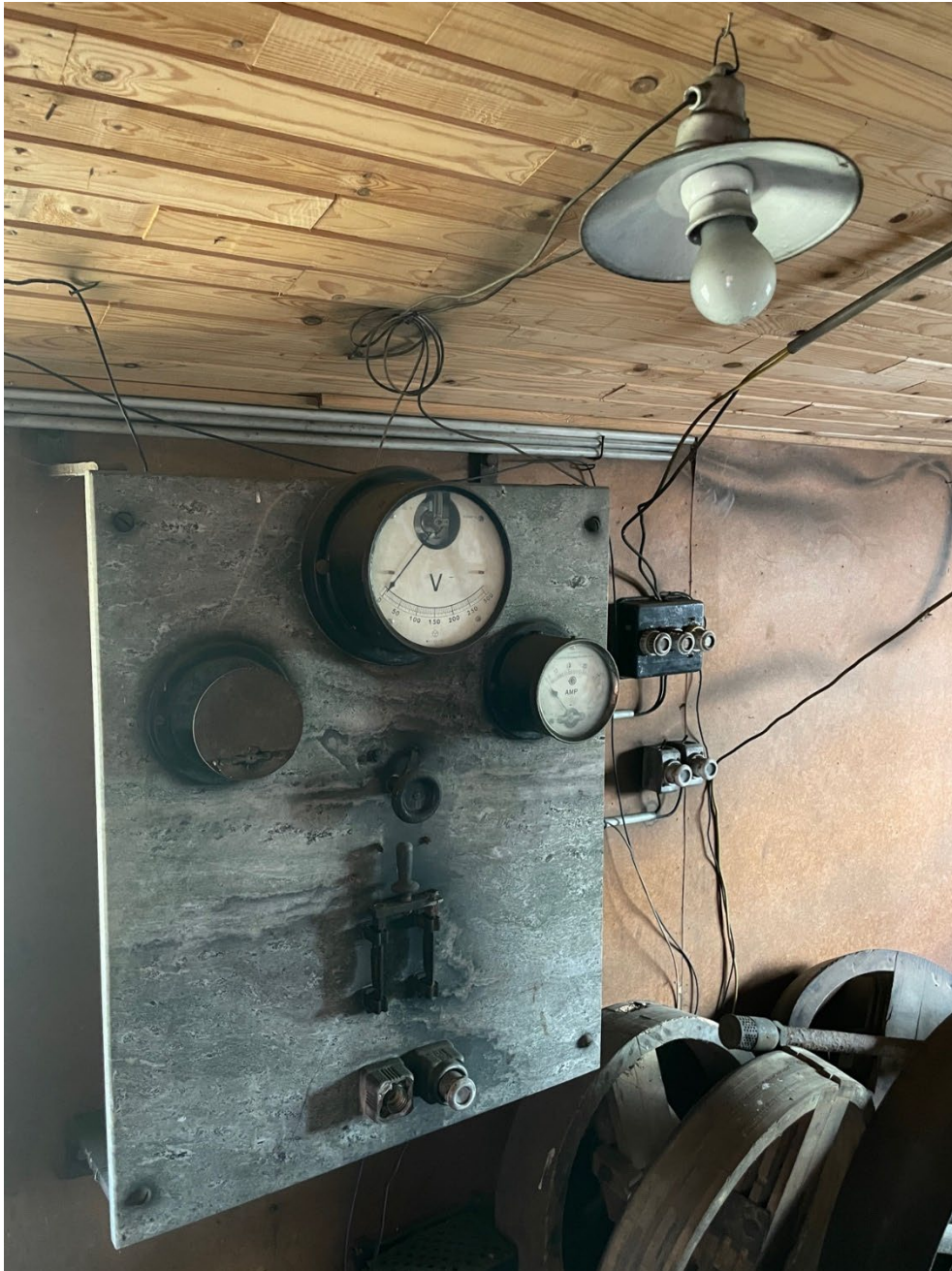
Äldre kontrolltavla i ett utrymme ovanför turbinsumpen.
