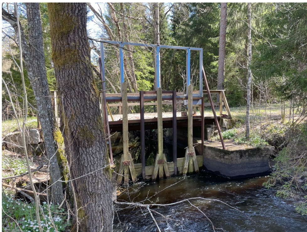
De tre dammluckorna.
