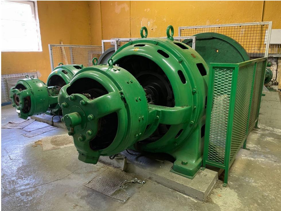
Kraftverkets båda synkrongeneratorer från Asea. Den mindre generatoren hör troligen till den ursprungliga utrustningen.
