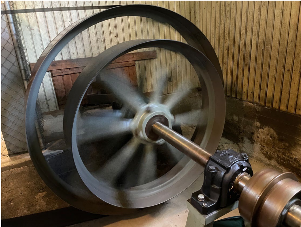
Delar av dagens maskinaggregat i Furulunds kraftstation.
