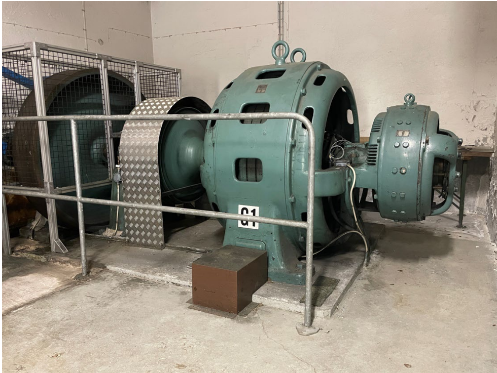
Generator med tillhörande matarmaskin i den äldre delen av kraftstationen.
