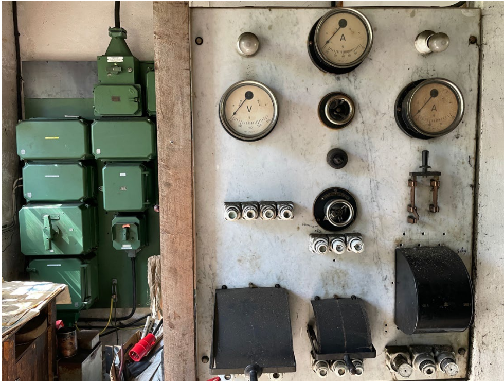
Äldre kontrolltavla i Drägveds gamla kraftstation.
