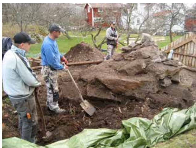
En rund överkragad källare där jorden grävs bort och konstruktionens utsida syns.
