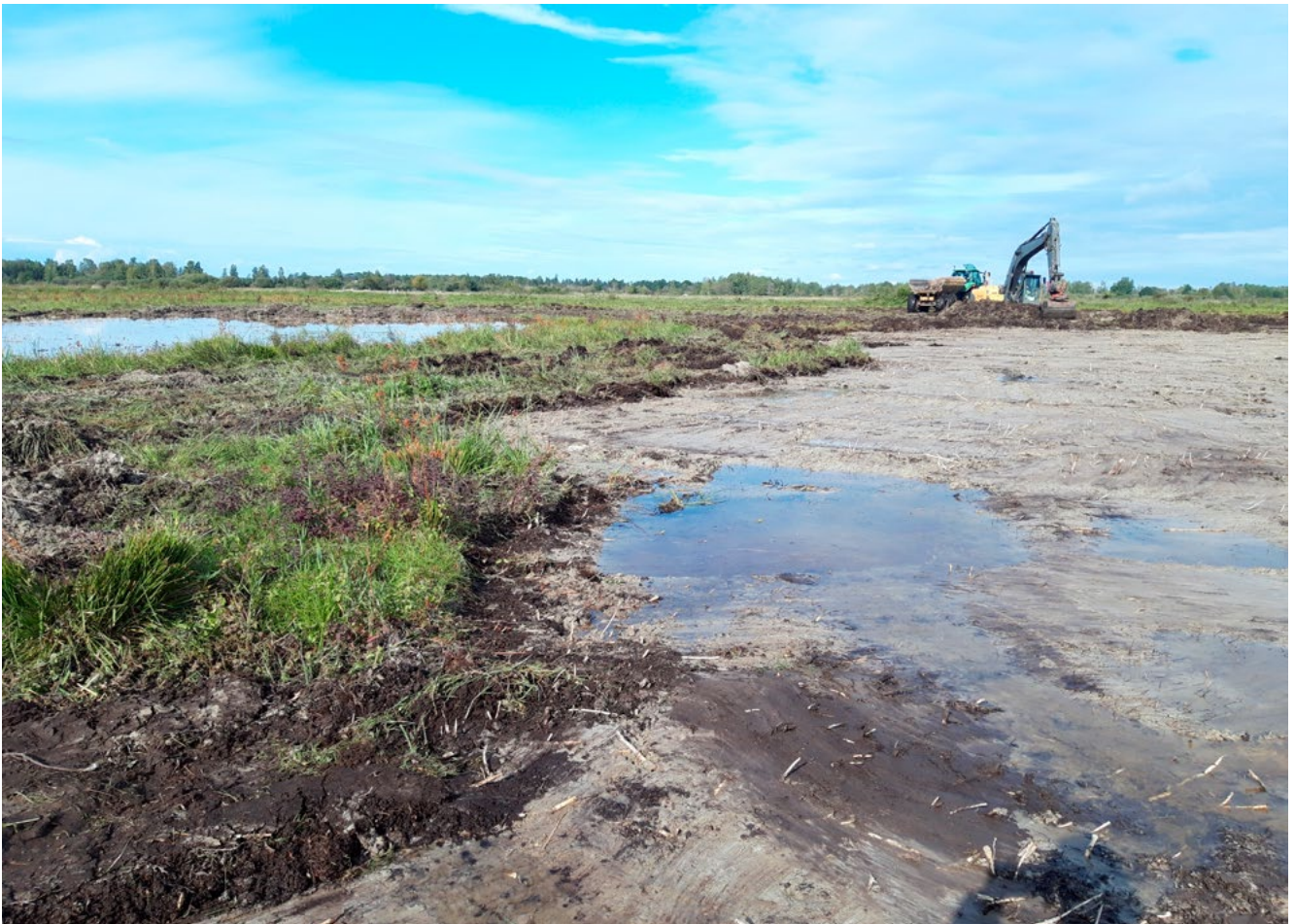
Figur 4.22. Grund schaktning för att ta bort organiskt material, bunkestarr och ag, Petgårdeträsk på Öland (foto: Marcus Arnesson).
