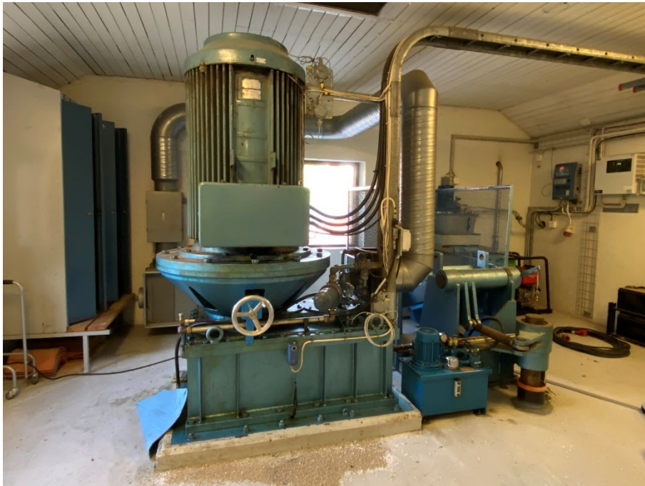
Figur 7. Asynkrongenerator från ASEA.
