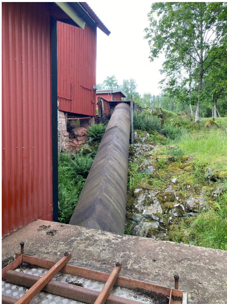
Figur 70. Ståltuben som leder från dammen ner till turbinen.
