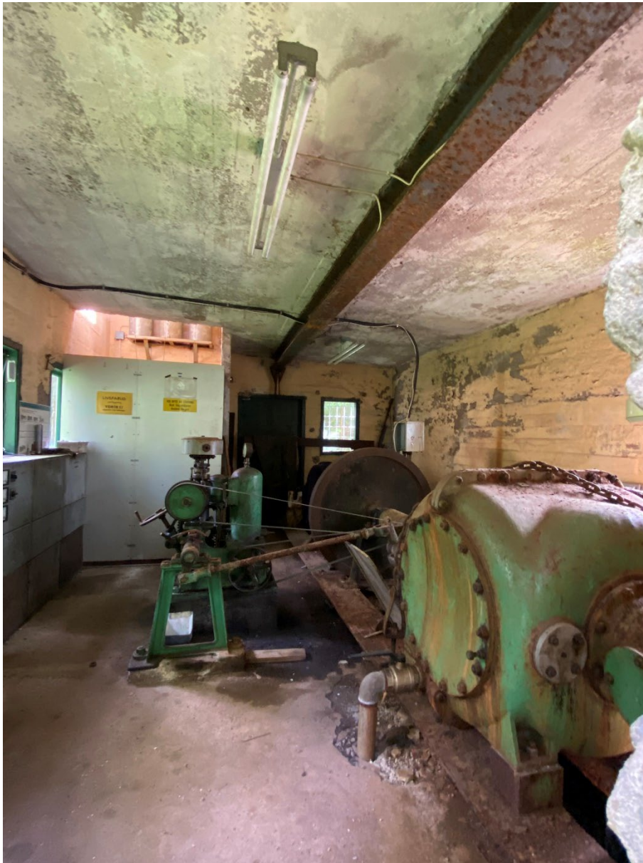
Figur 74. Kraftstationens interiör med turbinregulator, generator och svänghjul.
