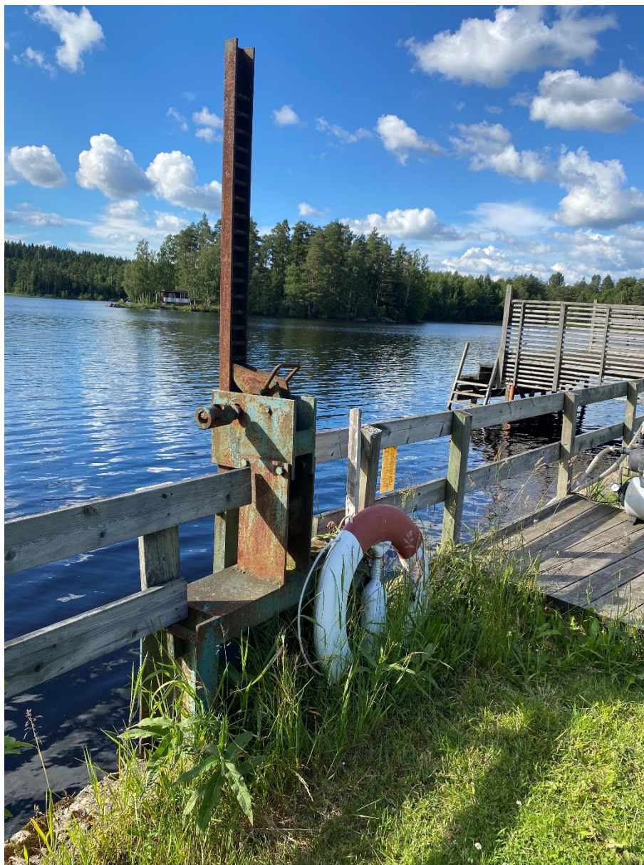
Figur 35. Utskov med spetlucka samt överbyggd intagskanal.
