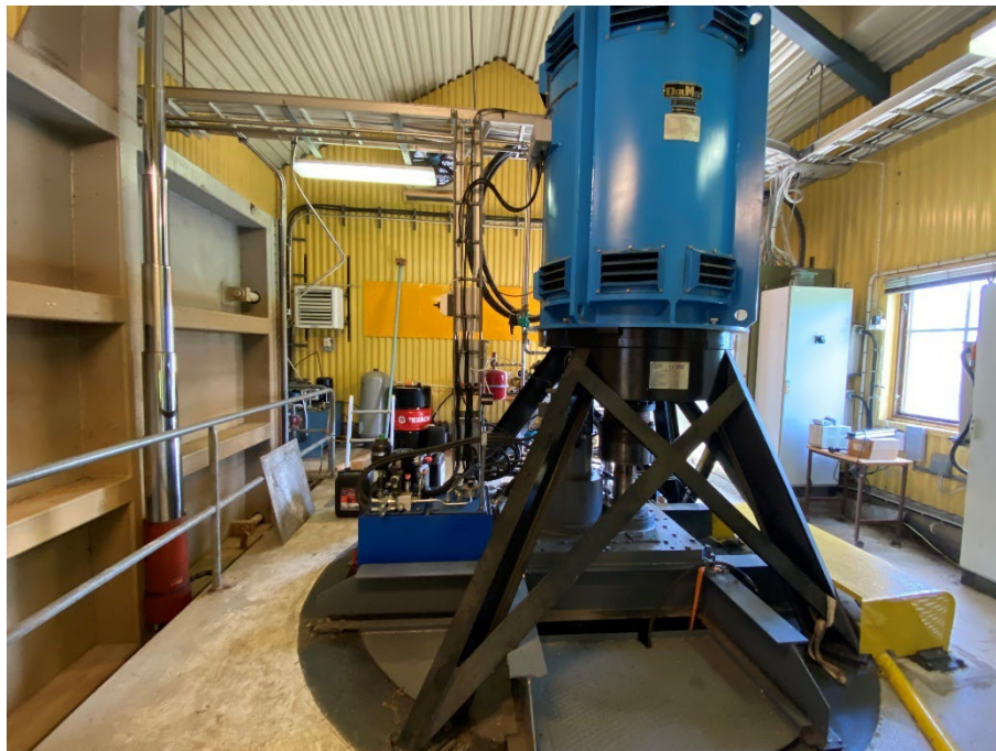
Figur 32. Maskinrummet på Källafors kraftverk.
