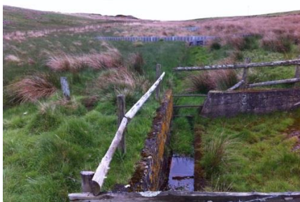
Bild 38. Barriärer av korrugerad plåt för att skapa längre uppehållstid för höga flöden i tillrinningsområdet till Belford, England. Konstruktionerna påverkar inte medelvattenflödet. Foto: Anita Bergstedt.
