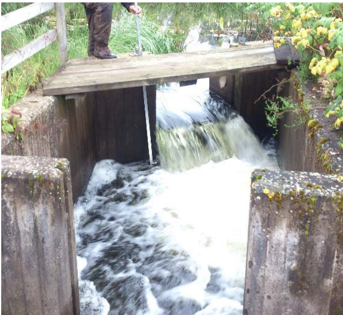
Figur 28. Exempel på felkonstruerat intag till slitsränna (Ätran, Västra Götalands län, ID174).
