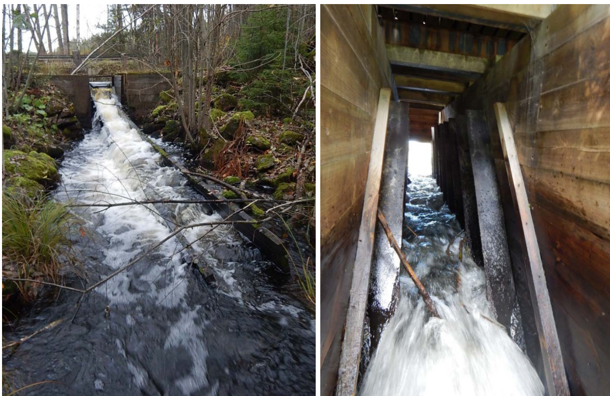
Figur 11 och 12. Vänster: Mer eller mindre raserad fiskväg orsakad av bristande underhåll (St Hammarsjön, Kalmar län, ID4690). Höger: Pinnar och kvistar i denilränna som bedöms ha funktionsnedsättning (St Bör, Värmlands län).
