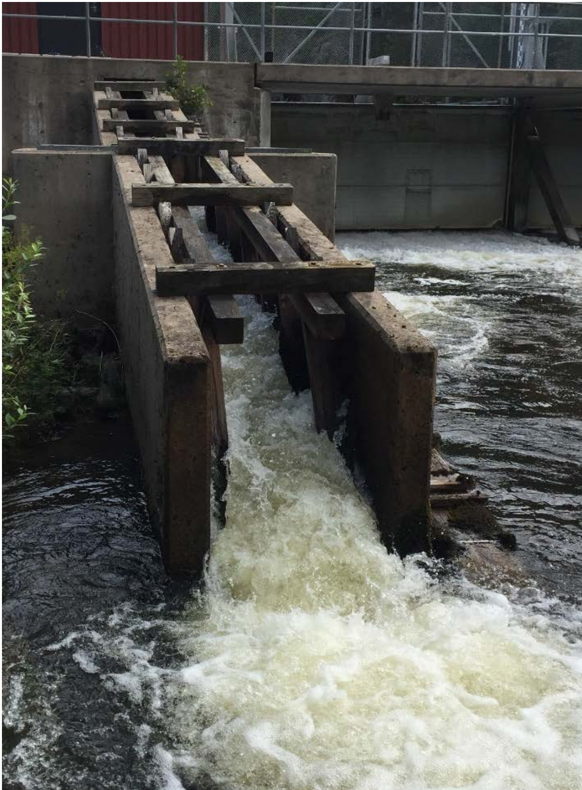
Figur 22. Exempel på felkonstruerad denilrännan vattnet "faller ur" rännan längst ner (Säveån, Västra Götaland, ID153).
