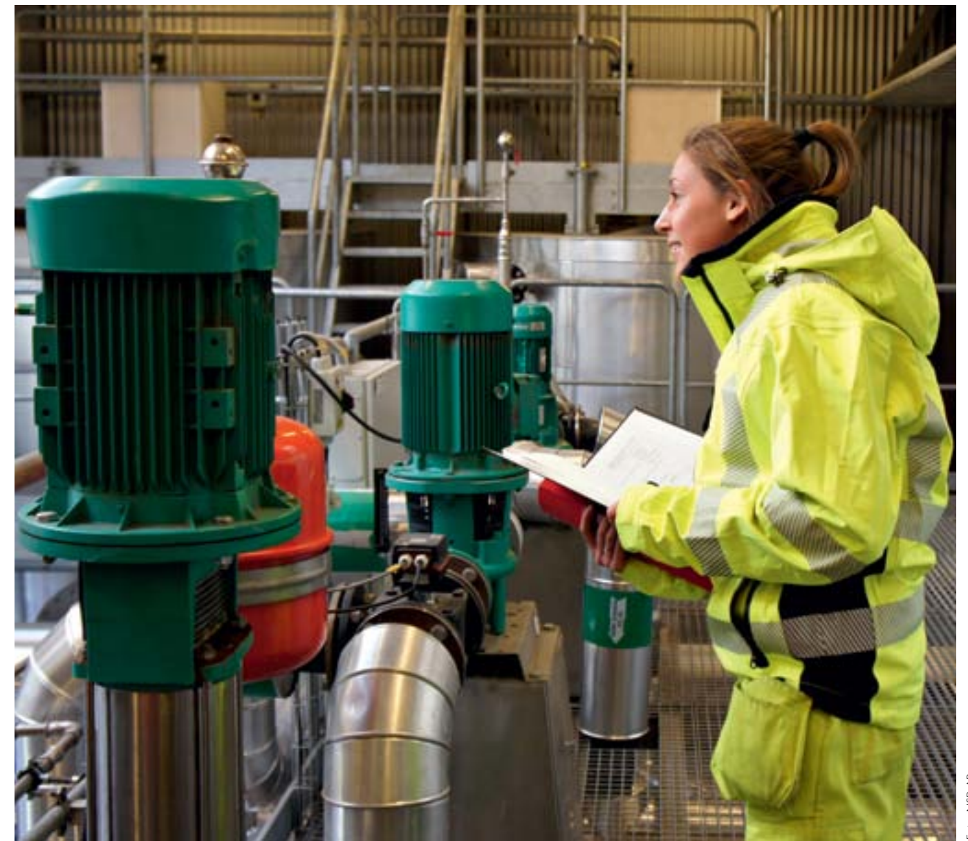
Behandling av matavfall för produktion av biogas och biogödsel. NSR, Helsingborg.
