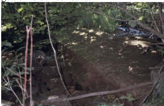
Dammdämme (vandringshinder nr 6). Definitivt vandringshinder för öring och lax. Foto: Torbjörn Davidsson
