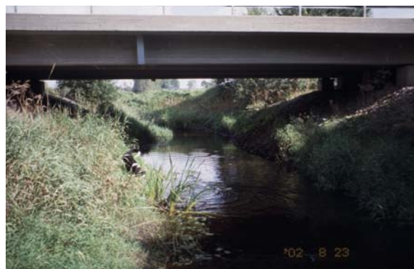
Landsvägsbro på sträcka 72 (A-prot.) i Röke å. Vid bropassager är vattendraget ofta djupt och skuggningen är dålig. Det finns också en risk att det sker ett läckage av giftiga ämnen från vägbanan ner i vattendraget.
