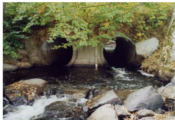
Vandringshinder nr. tre. Kulvertar under väg. Lutningen är relativt hög och vattendjupet dåligt vid lågt flöde. Oktober 2004. Foto: Samuel Hylander.
