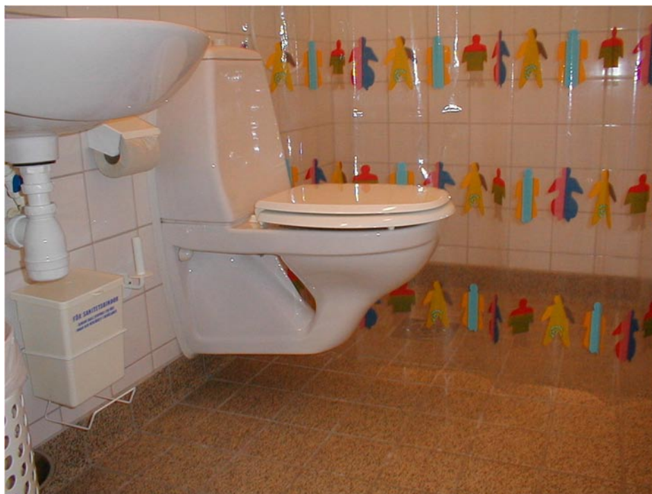
Vägghängd toalett är ett exempel på ett sätt att inreda som underlättar rengöring.
