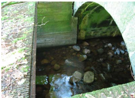
Vandringshinder 1 på A-sträcka 10. Hindret är definitivt och bör åtgärdas. Foto: Marie Eriksson.
