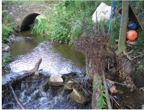
Vandringshinder 6 och vattenuttag, A-sträcka 29 Foto: Madeleine Wåland
