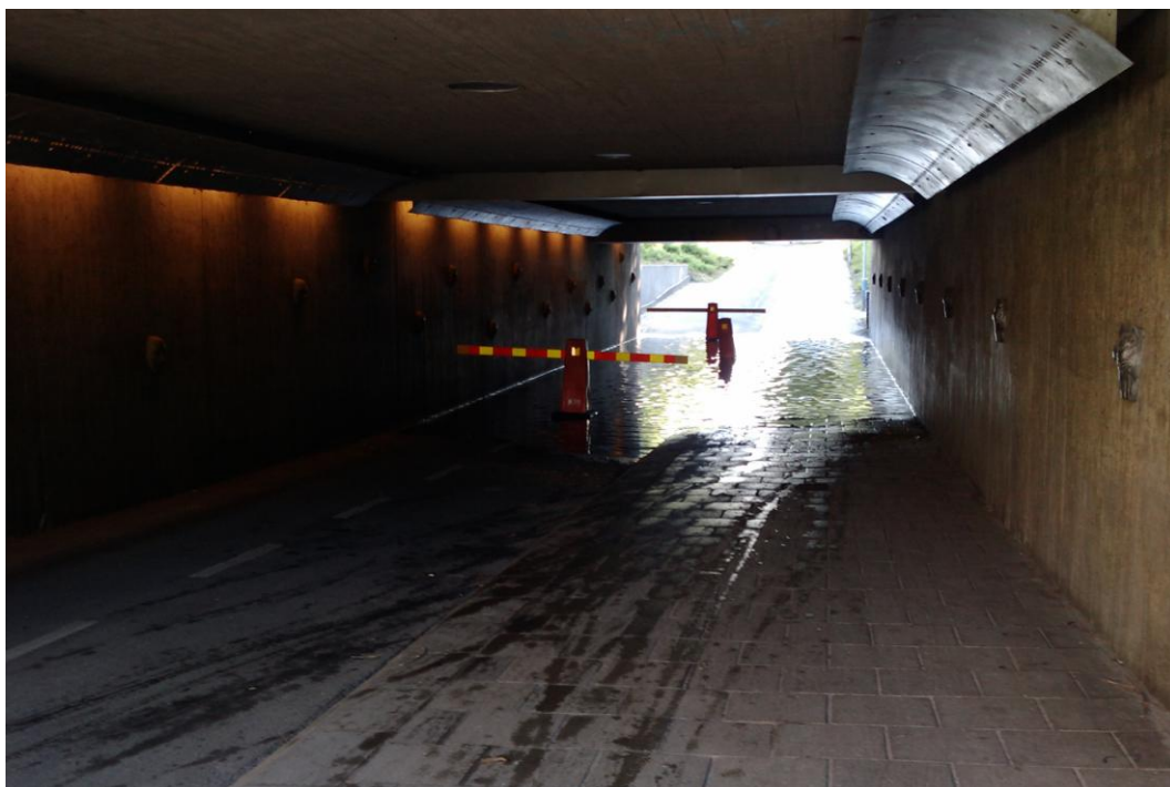
Översvämmad gångtunnel under Amiralsgatan © Tanja Stähle, 2011
