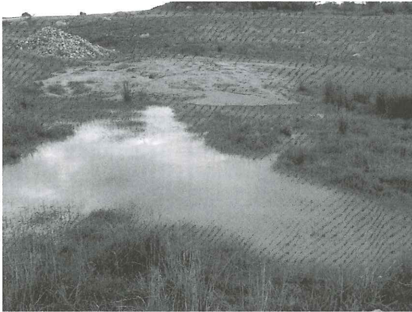
Vattensamling intill baslokalen vid "Plattan".
