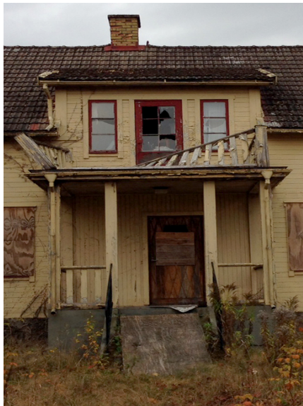
Förfallen byggnad. Foto: Anette Klang
