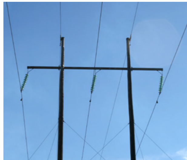
Luftledning. Foto: Lena Ottebo
