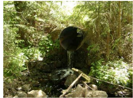
Foto 3. Dåligt anlagd vägtrumma i Ribäcken.
