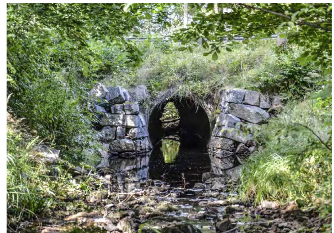
Figur 75. Södra delen av vägen över bäcken med cementrör inlagt under vägbanan. Foto mot norr.
