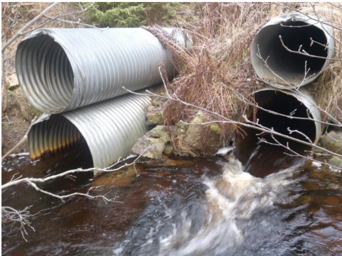
Figur 5. Vägtrummor vid järnvägen
