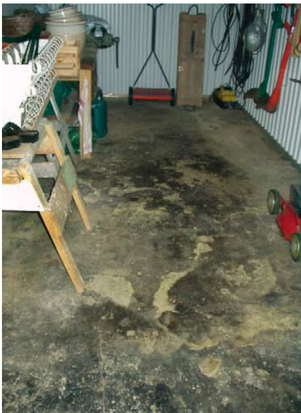
Bild 3. Missfärgningar i golv på grund av föroreningarna. Fotograf: Lena Torin
