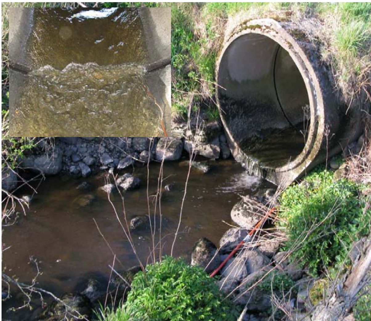
Figur 61. Brotrumman vid Allarängen befanns vid inventeringen sprucken och kraftigt läckande. En stor del av vattnet rann därmed under själva trumman. Varken nejonögon eller öring bedömdes ha möjlighet att passera. Foto Nils Ljunggren.
