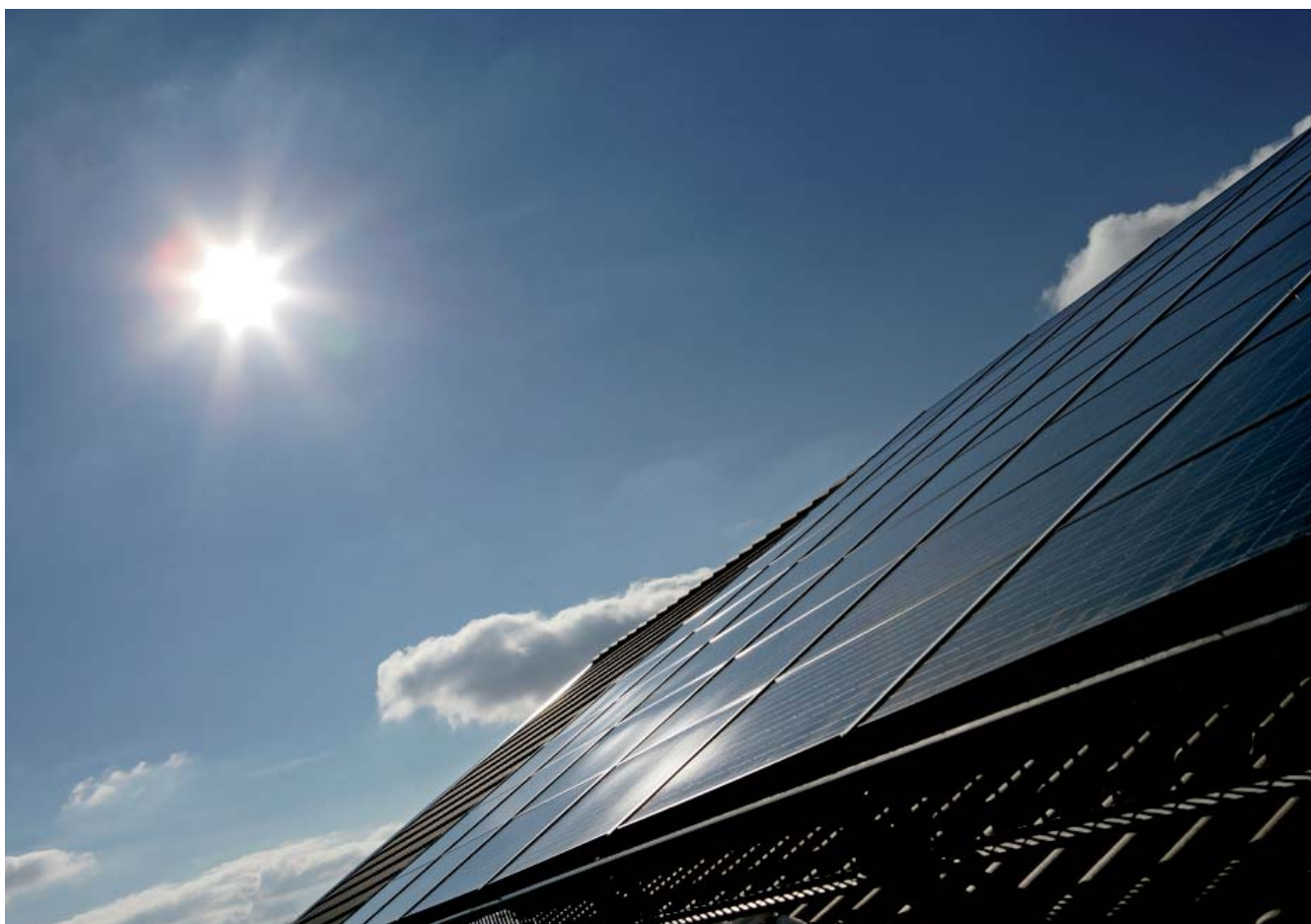
Solenergi är ett område med stor utvecklingspotential. Här ses solceller för elproduktion monterade på taket till Fjärås nya vårdcentral. Foto: Eksta Bostads AB
