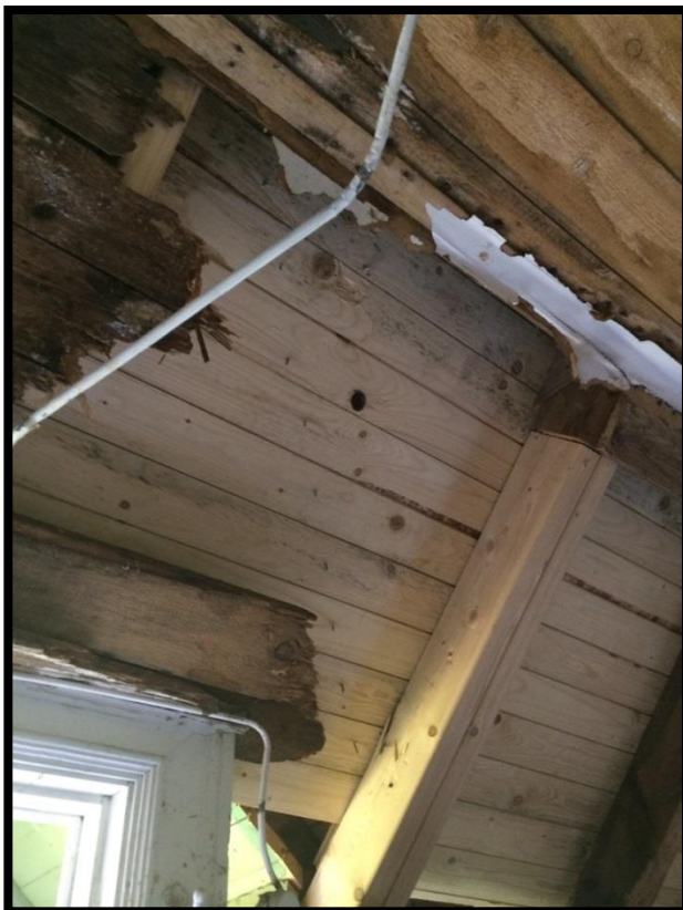
Figur 55: Lusthusets tak har stora fuktskador.
