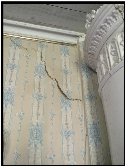
Figur 52: Sättningar i huset orsakar skador på väggar och ytskikt.
