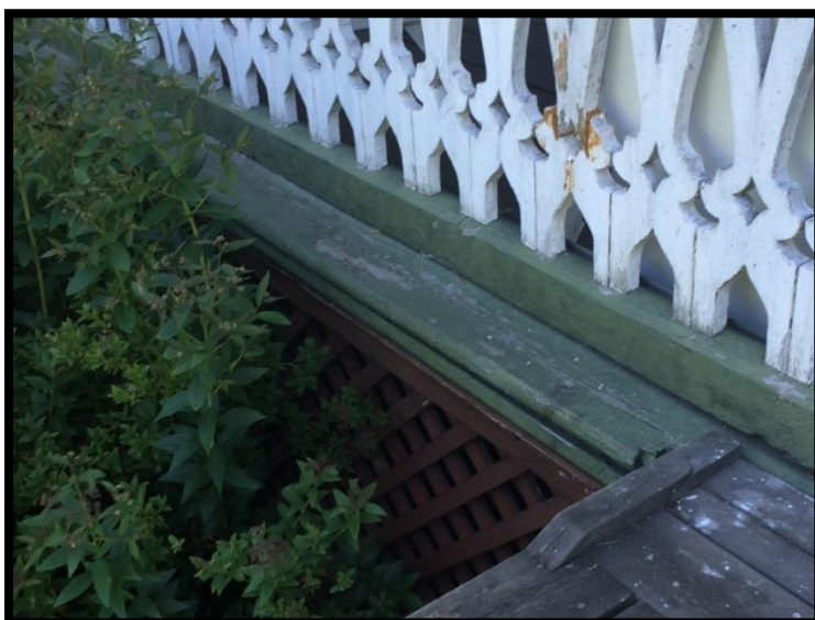
Figur 53: Verandans snickerier samt list mot stensockeln är i dåligt skick.
