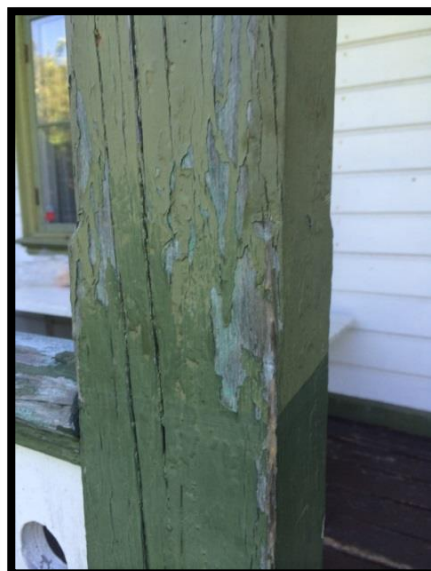
Figur 54: Färgen flagar från verandans pilastrar. Här kan man också se nyanser av tidigare färgsättning.
