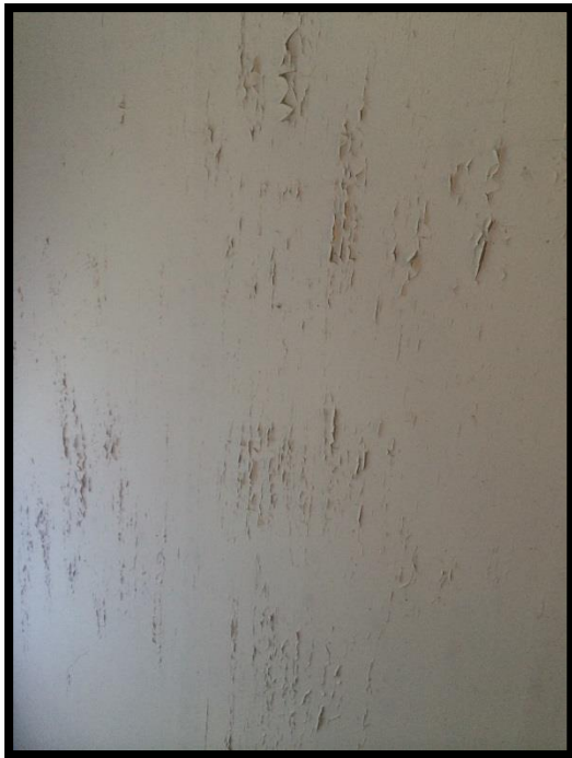
Figur 55: Flagnande färg på bottenvåningens innertak.
