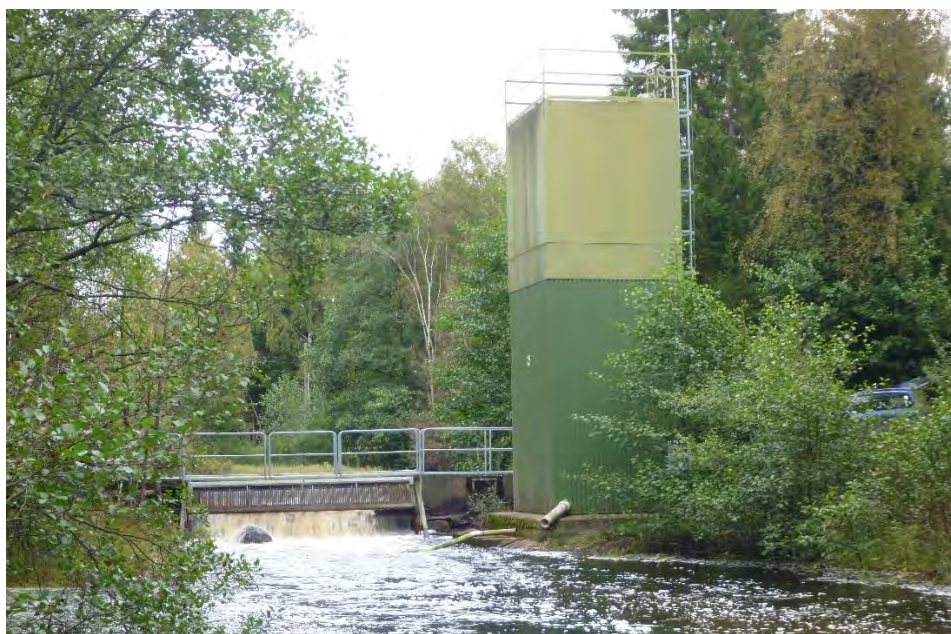
Kalkdoseraren i Fönhultaån, Varbergs kommun
