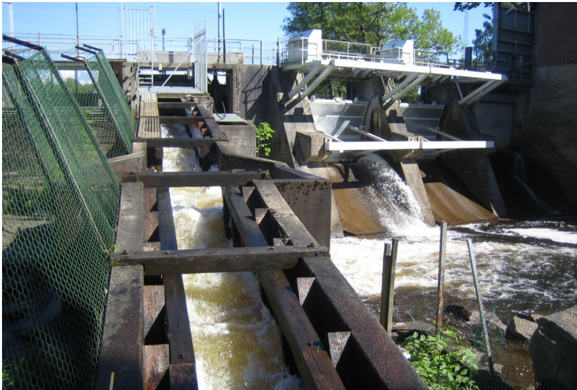
Figur 3. Fiskväg av motströmstyp vid Hertings kraftverk med stigrännor och vilobassänger. Vy från utloppskanalen mot dammbyggnaden och flodluckorna.
