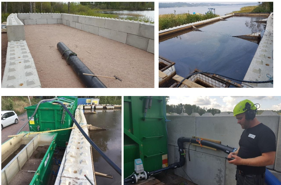
Figur 13. Avvattningsanläggning vid Ralången 2019. Rejektvattnet passerade ett sandfilter och via avtappningsrör till sjön. Vid avtappningsröret fanns kran för ta ut prover på rejecktattnet.
