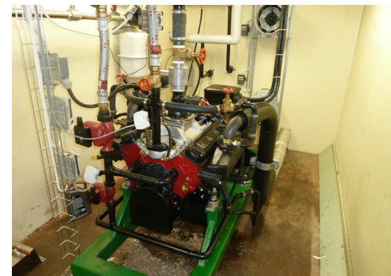
Generatörummet där elen produceras.
